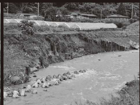
▲平成26年7月、濁流によって削られた河岸(金山地区)。河川の近くは、常に水位に警戒が必要
