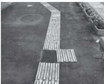
剥がれた点字ブロック
