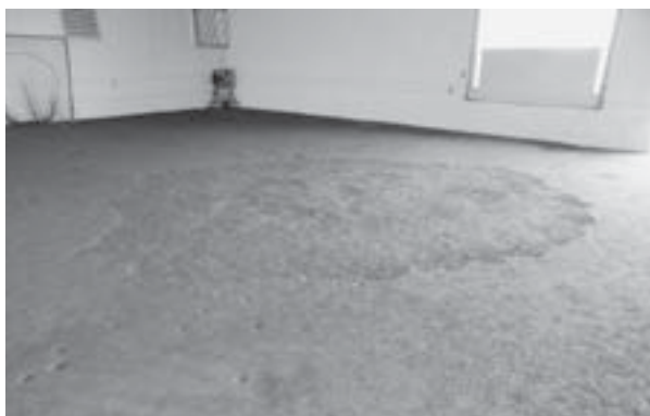
土が割れて危険なピロティ内部
